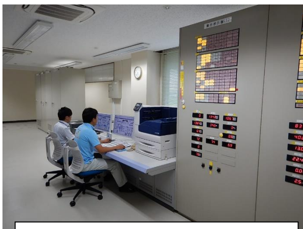
福井臨海工業用水道管理事務所 中央監視制
